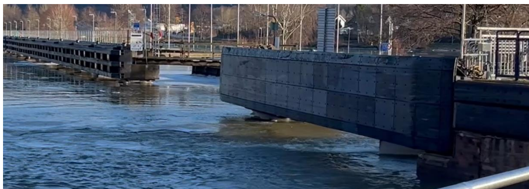
Figur 4. Östra slussinfarten (uppströmssidan) med fendrar och ledverk utanför den marina rastplatsen i bakgrunden.
